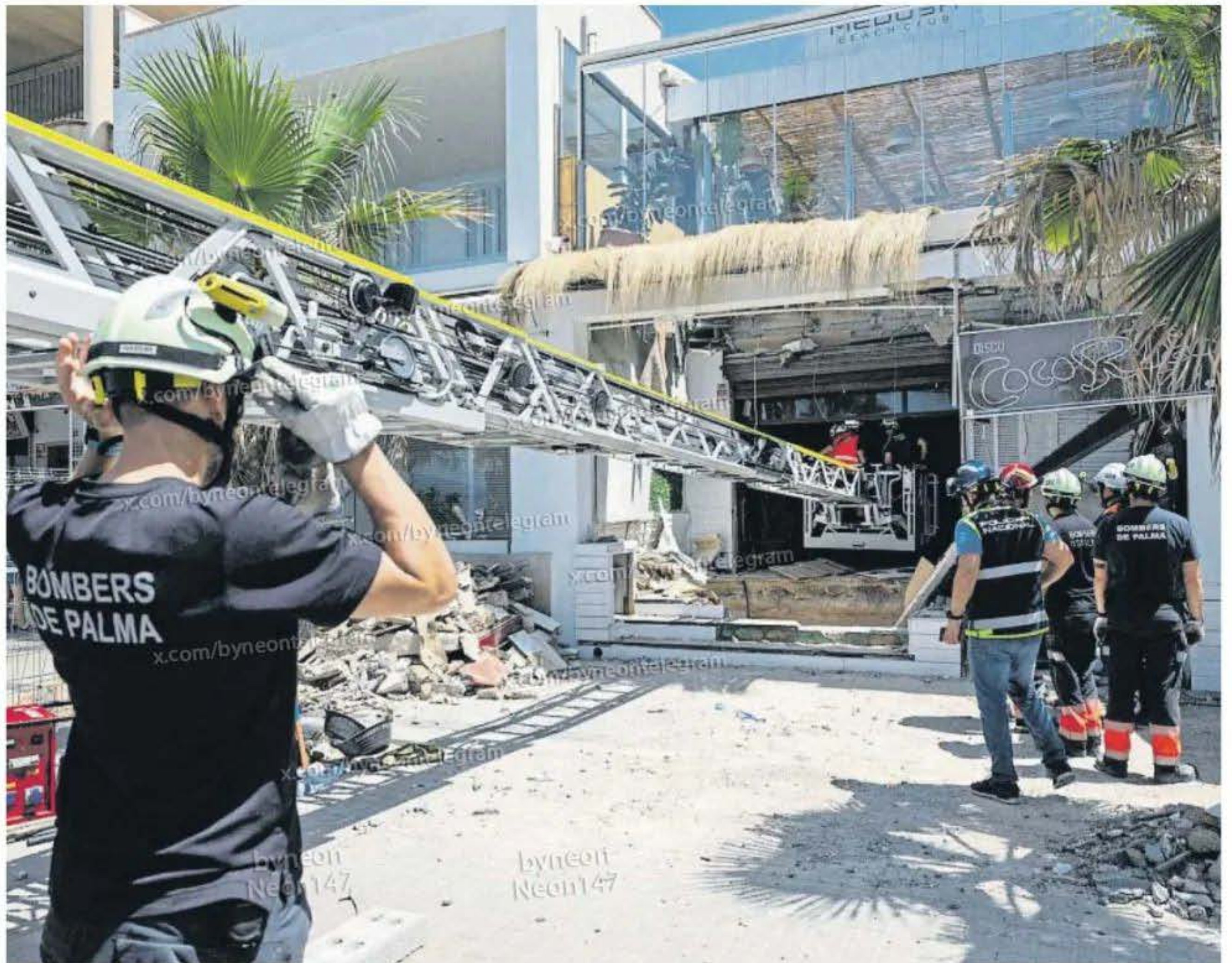
Los bomberos trabajan un día después de que el club-restaurante de dos plantas se derrumbara causando cuatro muertos y 16 heridos
