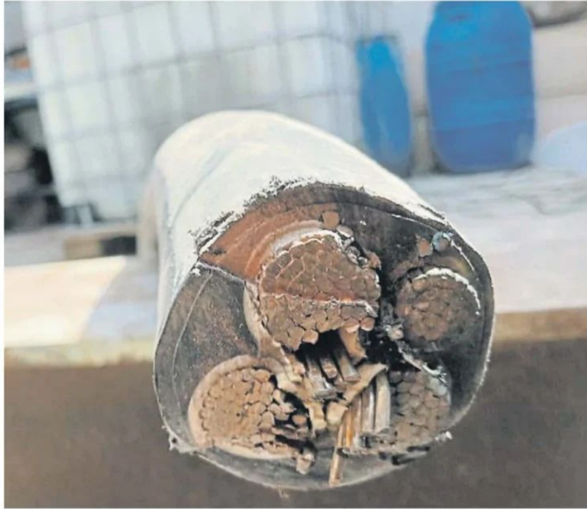
Detalle del cable de cobre seccionado y robado
